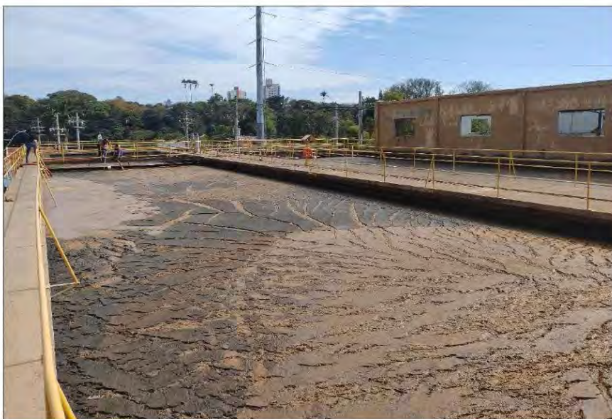
Foto 16 – Material sobrenadante ocupando a superfície dos dois decantadores da ETA2 (03/Ago/2024).
