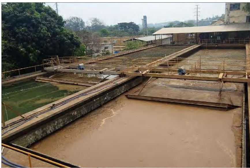
Foto 50 – Vista do decantador 01, sendo bombeado. O rebaixamento do nível do tanque é bem perceptível (15/Set/2024).
