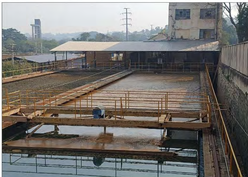
Foto 39 – Uma semana após a remoção dos resíduos do decantador 1 da ETA1, o material sobrenadante já se acumulava novamente (05/Set/2024).
