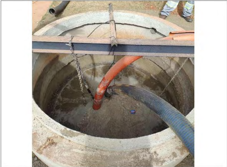
Foto 29 – EEE em funcionamento (03/Ago/2024).
