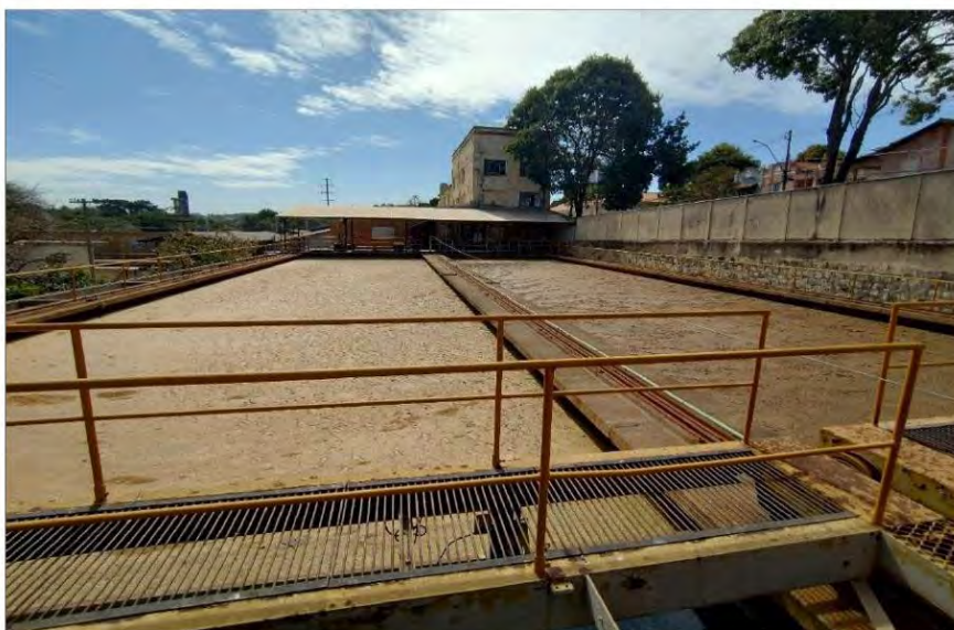
Foto 20 – Decantadores da ETA1, sendo que o da esquerda é aquele que foi esvaziado na noite de 22/Jul. Note-se que o material sobrenadante já ocupa toda a superfície do tanque (03/Ago/2024).
