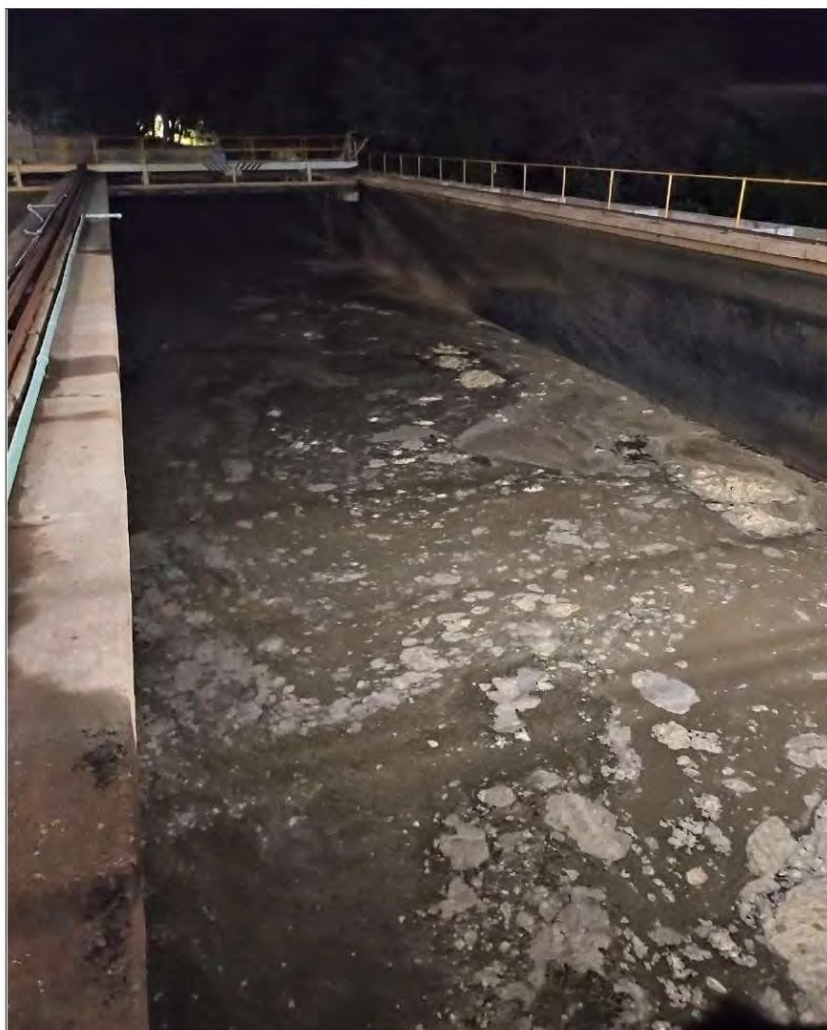
Foto 5 – Decantador esvaziado, já em processo de reenchimento. Note-se o material sólido depositado no fundo do reservatório, que seria lançado no Rio Piracicaba na sistemática semanal que o Sema adotava até então.
