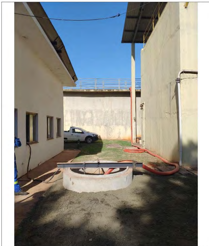
Foto 23 – Estação elevatória enterrada, criada pela empresa Águas do Mirante para descarga dos efluentes por gravidade, trazidos pelos caminhões tanque, e bombeamento para o decantador que estava ocioso, cuja parede lateral se vê ao fundo, atrás do veículo. Note-se a mangueira de bombeamento da EEE para o decantador (03/Ago/2024).
