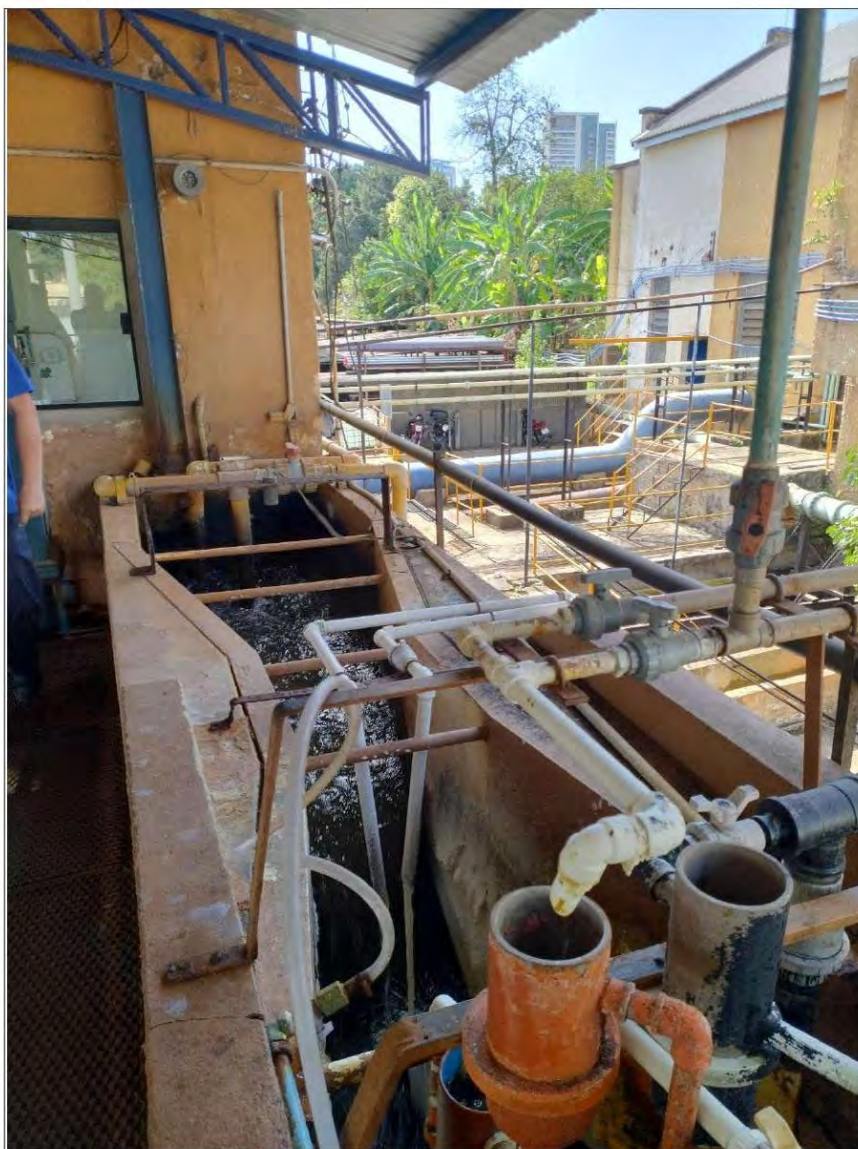
Foto 18 – Medidor de vazão Parshall e dosímetros dos produtos químicos usados no tratamento inicial da água bruta (antes do decantador) (03/Ago/2024).
