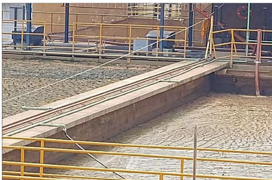
Foto 51 – Note-se a diferença de nível, entre o decantador 01 e o decantador 02.
