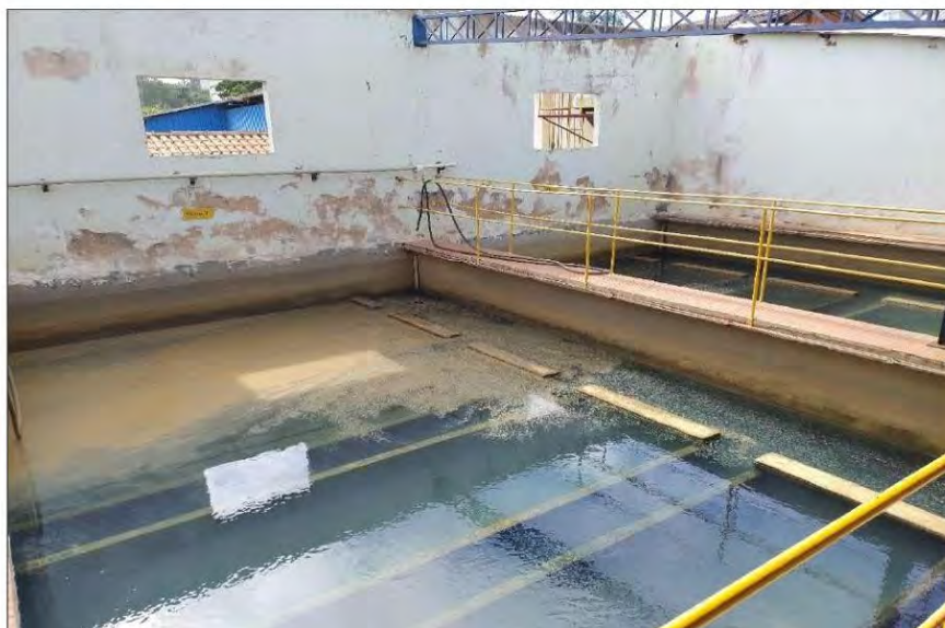
Foto 19 – Material sobrenadante interferindo nos filtros da ETA2, após os decantadores (03/Ago/2024).
