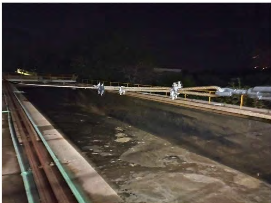
Foto 6 – Decantador esvaziado, já em processo de reenchimento. Note-se o material sólido depositado no fundo do reservatório. Restaram também alguns materiais sobrenadantes que não foram despejados no processo de esvaziamento (noite de 22/Jul/2024).
