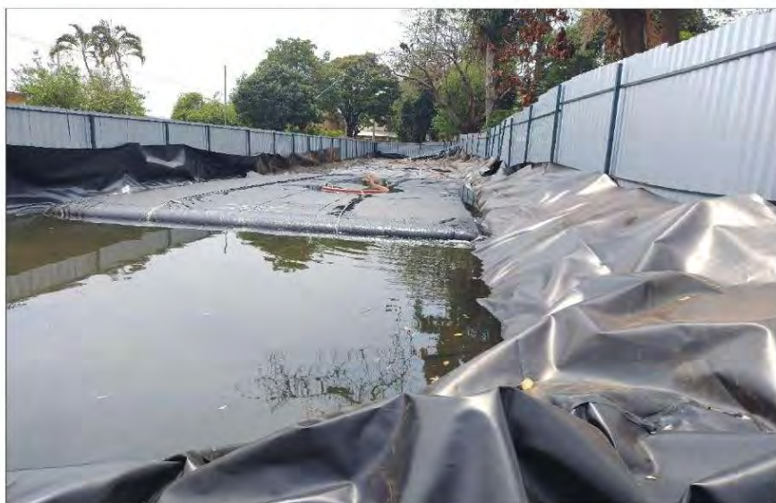
Foto 48 – Água que é filtrada através do Bag, fica retida no PAD e é bombeada de volta para a ETA (15/Set/2024).
