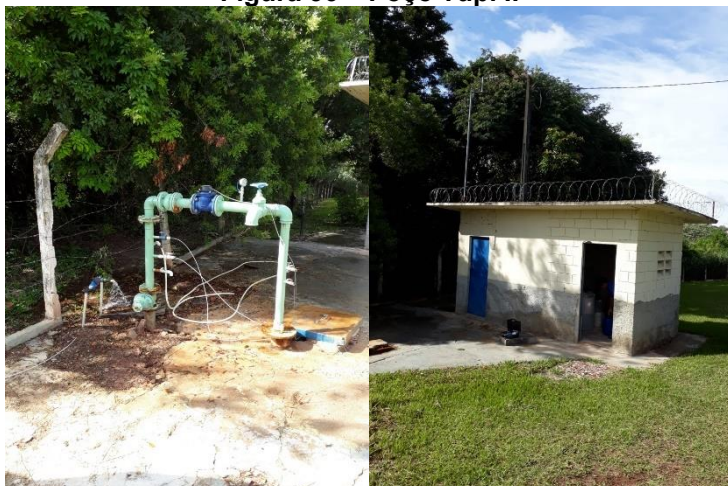
Figura 36 – Poço Tupi II
