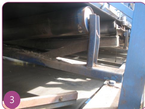
Estruturas presentes onde o trabalhador foi se chocando.
