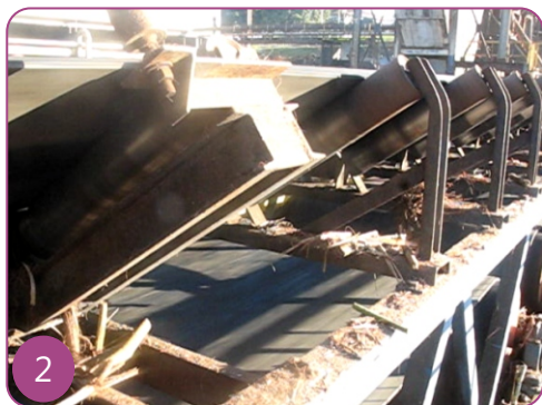
Local onde o trabalhador caiu.
