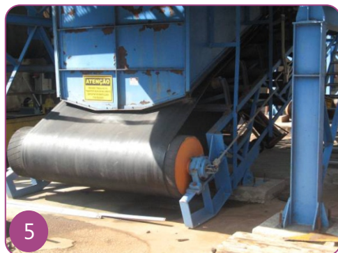
Transmissão de força desprotegida.
