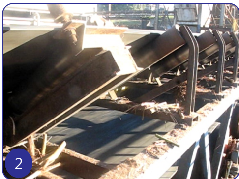
Local onde o trabalhador caiu.
