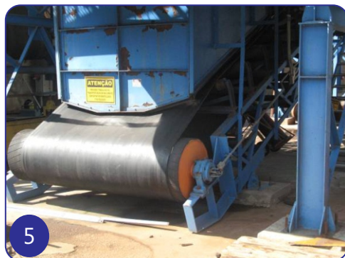
Transmissão de força desprotegida.
