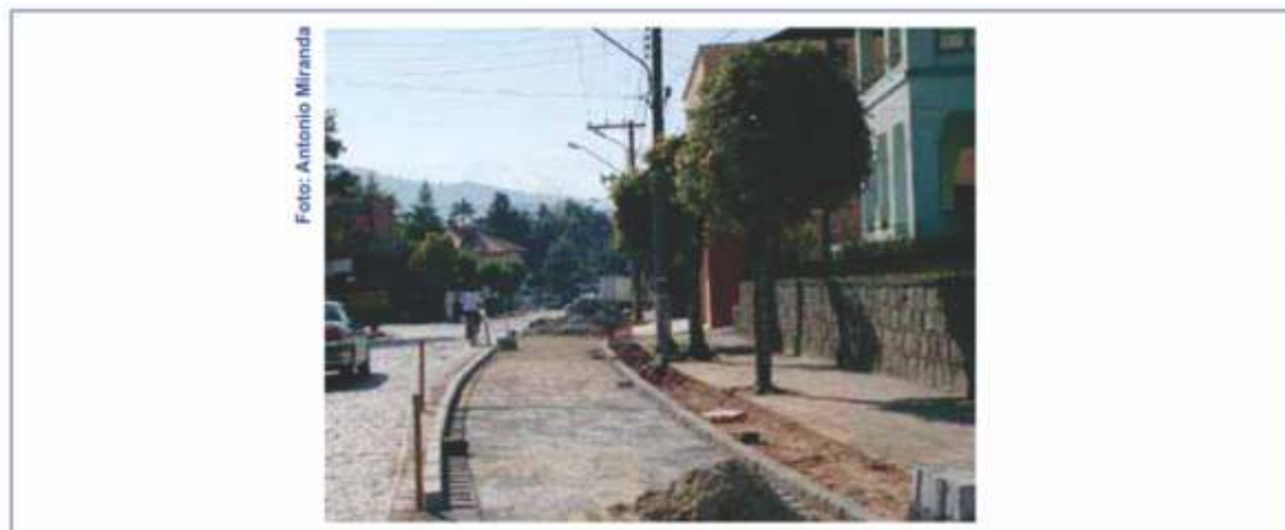
Ciclovia separada do tráfego motorizado por meio-fio, em obras Pomerode/SC, 2006 - Fonte: IB IDEM
