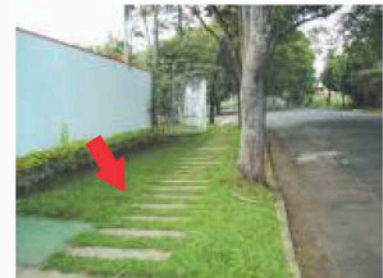
Fig. 26 – Calçada descontínua com grama entre placas de concreto. Portanto, não possui faixa livre contínua.
