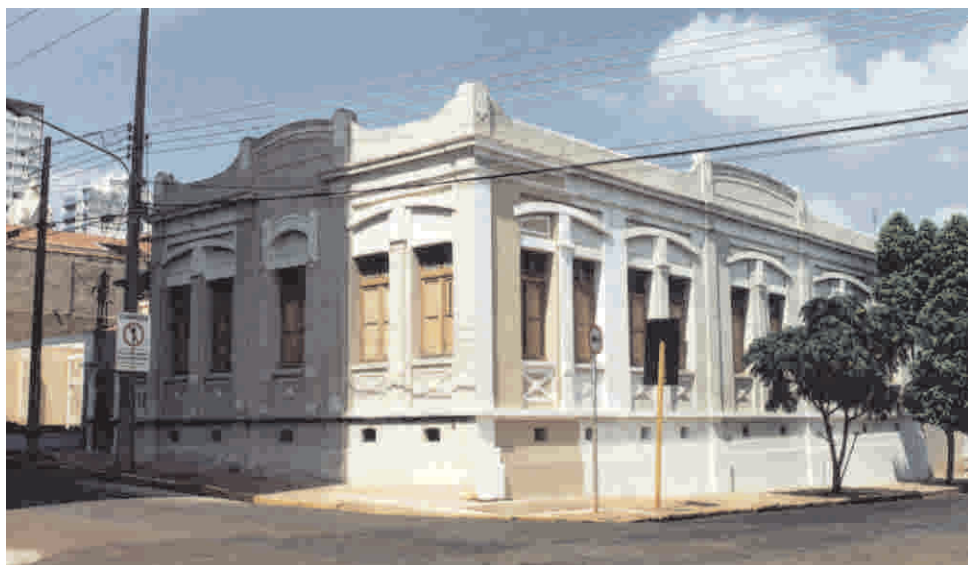
Fig. 30 - Imóvel tombado sendo restaurado. Respeito com esquadrias e elementos ornamentais originais é fundamental.
