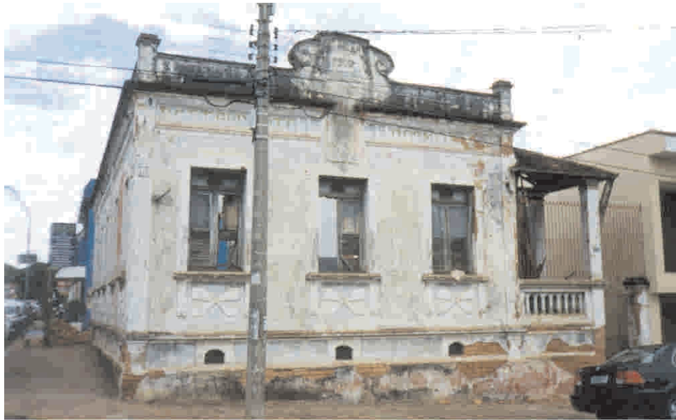
Fig. 31 - Na região central imóveis são demolidos ilegalmente sem autorização do CODEPAC.
